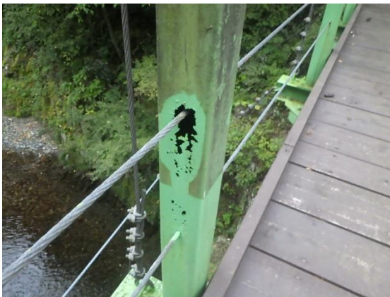
写真 15 高欄の断面欠損によるC 1判定 (No. 8 下日向橋)
