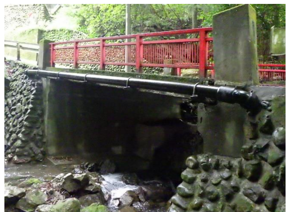
写真6 No.4 森の前橋 泉沢を渡河する橋梁、橋長 6.3) 構造形式：単純 PC 床版橋
