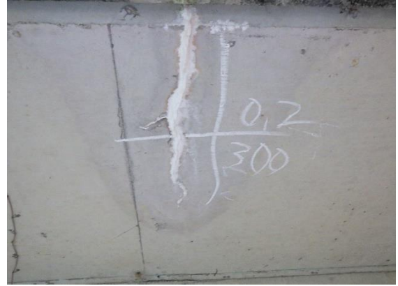
写真 14 床版の遊離石灰によるC 1判定 (No. 10 西川橋)
