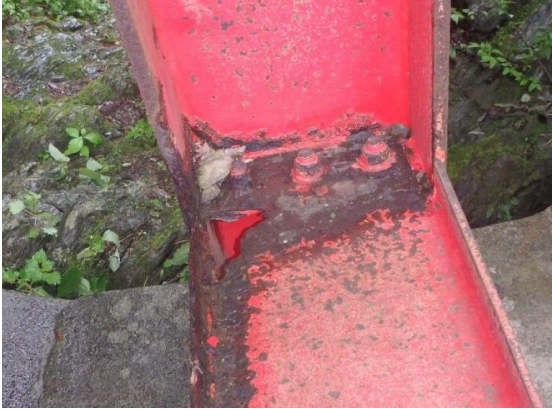
写真 13 主構の腐食によるC 2判定 (No. 1 和田橋)
