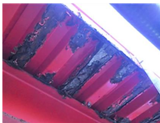
写真10 鋼床版の腐食によるC 2 判定 (No. 68 清水橋)
