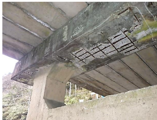
写真12 橋脚の鉄筋露出によるC 2 判定 (No. 47 下神戸橋)
