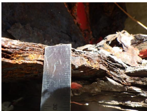
写真7 No. 49 小沢橋：主桁 (板厚減少を伴う腐食)
