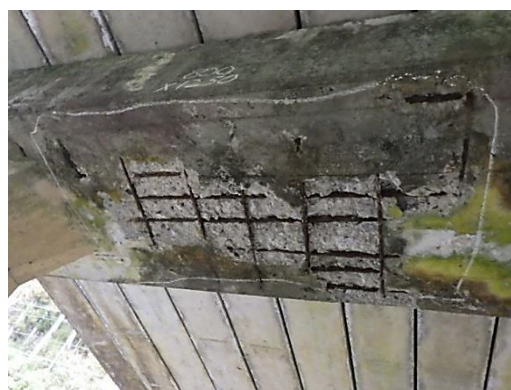
写真8 No. 47 下神戸橋：橋脚 (剥離・鉄筋露出)
