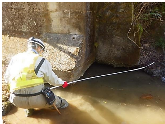
写真11 橋台の洗掘によるC 2 判定 (No. 41 36号無名橋)
